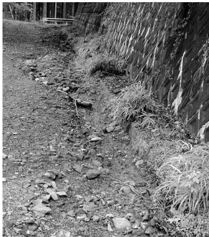
荒廃した林道
