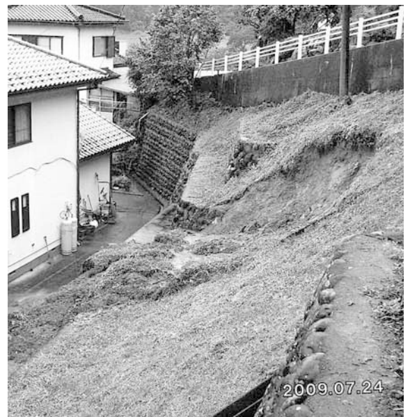
本郷地内被災状況
