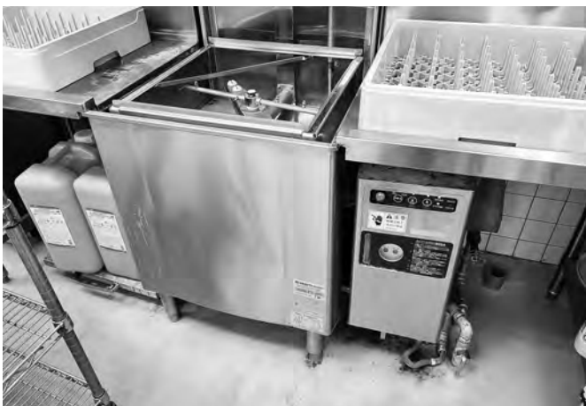
交換前食洗器（富沢デイサービスセンター）
