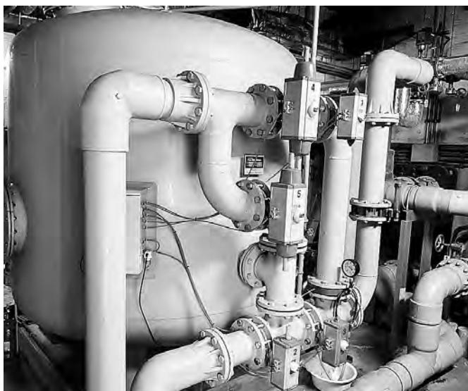
スポーツセンタープールろ過装置
